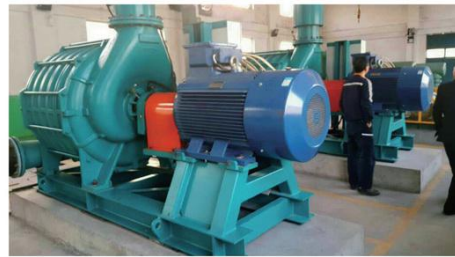
郑州客户现场 Zhengzhou customer site
